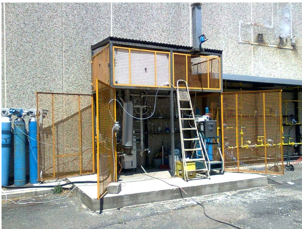
Fig. 1: Mini impianto di gassificazione GESSICA
