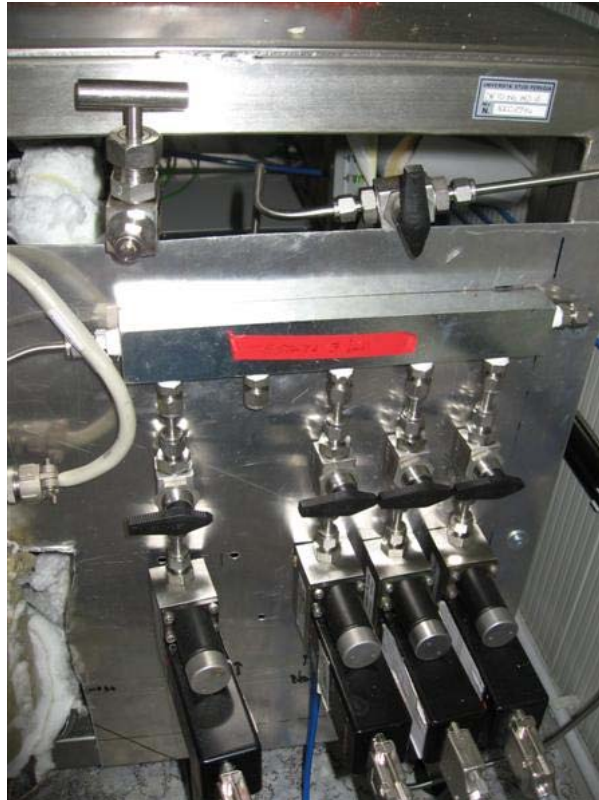
Figura 38. Flowmeters e manifold lato anodico. Si nota la presa di campionamento del mix anodico.
