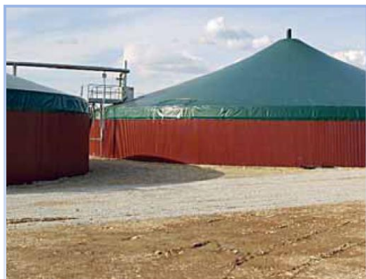
Figura 9 – Copertura gasometrica con doppia membrana. Si noti la membrana di protezione.
