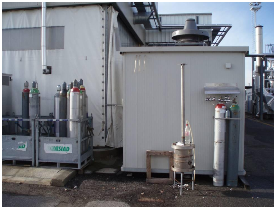
Figura 4 – Locale dove è sistemata la cella MCFC
