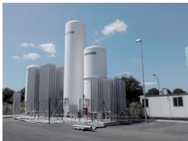
Sezione gas tecnici di supporto
