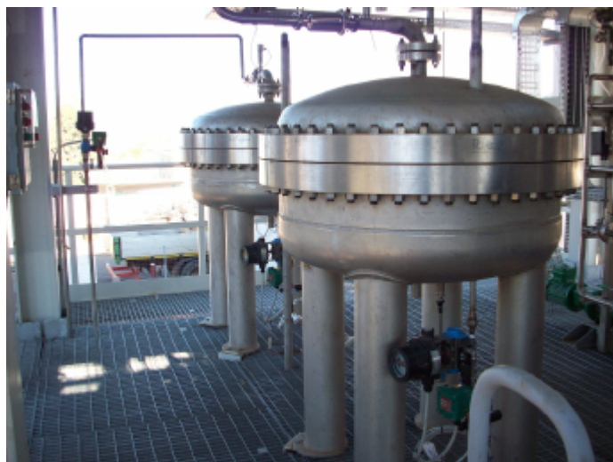
Figura 13: reattori di assorbimento della CO 2
