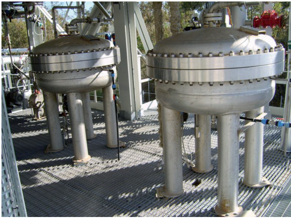
Dettaglio separatori CO 2
