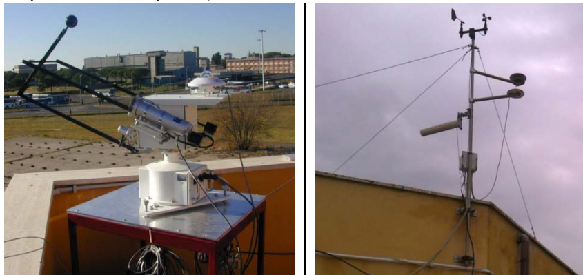
FIGURA 36: Stazione di acquisizione dati solari e stazione meteo (Urtin-Pci)
