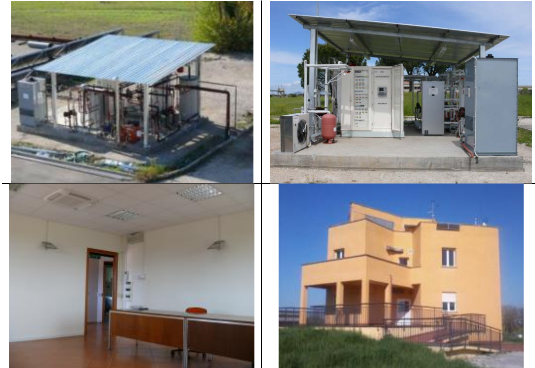
FIGURA 15: Viste dell'impianto e dell'edificio F-92
