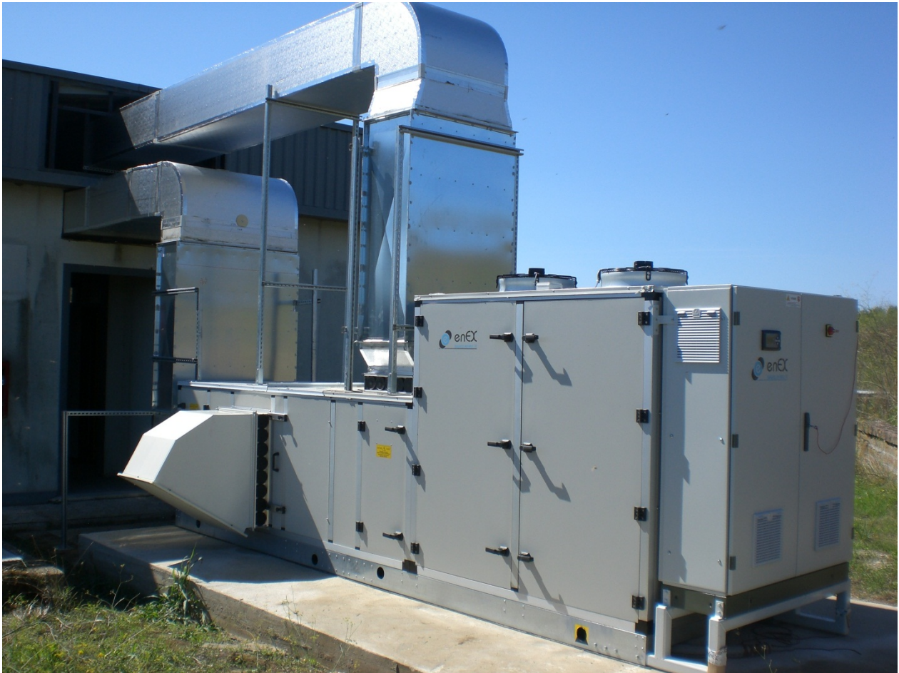
Figura 32. Installazione del roof-top e collegamento ai canali di mandata e ripresa aria (lato sx)
