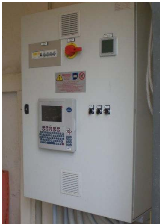
Figura 31. Quadro elettrico di potenza e controllo
