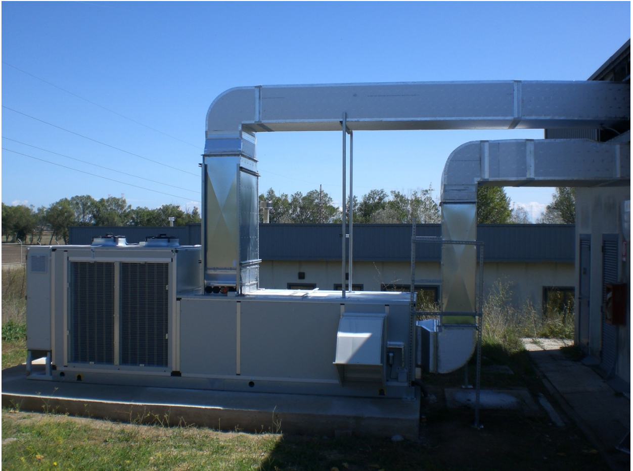
Figura 33. Installazione del roof-top e collegamento ai canali di mandata e ripresa aria (lato dx)
