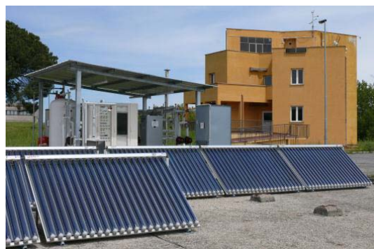
Campo solare impianto "solar cooling" F92 (Centro Ricerche ENEA Casaccia)
