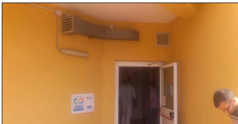
Figura 1.1.7 - Presa d'aria esterna ed estrazione al piano terra dell'edificio F92
