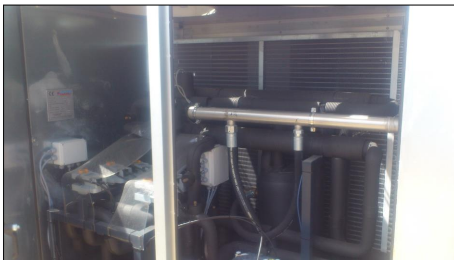
Figura 1.1.3 - Scambiatore esterno della roof-top visto dall'interno ed unità ventilante
