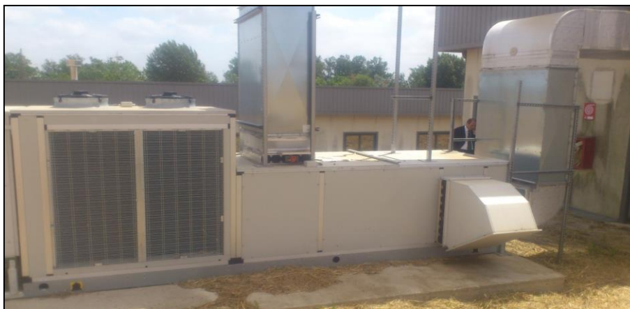
Figura 1.1.2 - Rooftop a CO 2 , con evidenza dello scambiatore esterno
