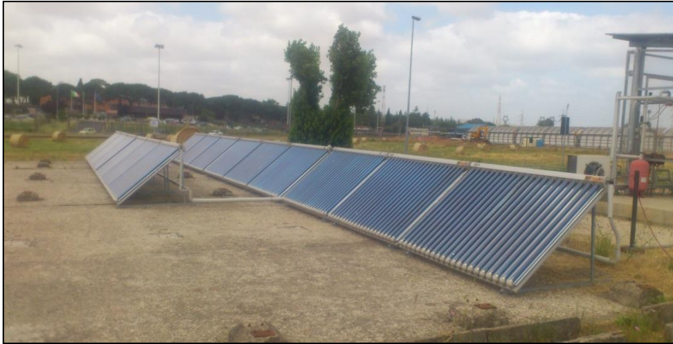
Figura 1.1.4 - Campo di collettori solari a tubi evacuati in due stringhe, per 56 m 2 complessivi
