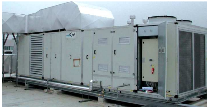
Figura 19 Unità roof top di grande capacità con generatori termici a gas.
