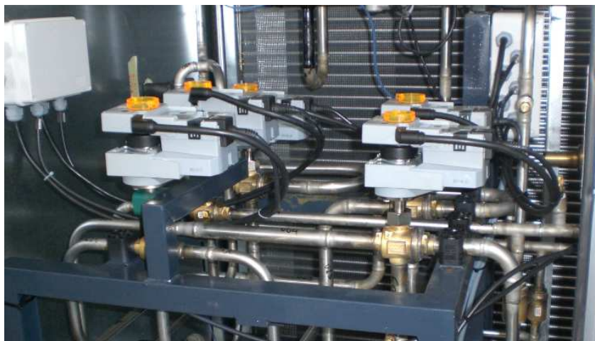
Figura 46 Valvole motorizzate del roof-top.
