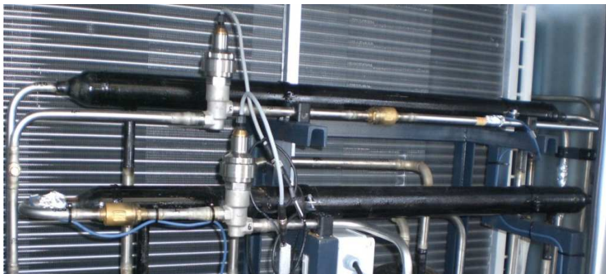
Figura 41 Rigeneratori installati sulla pompa di calore.
