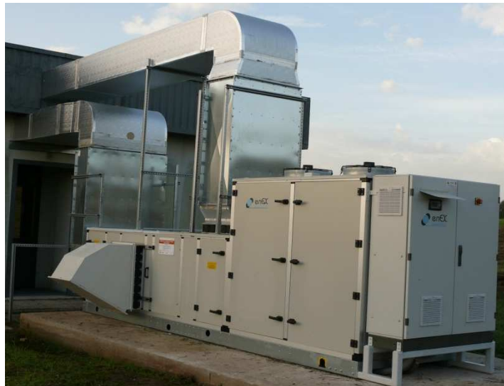
Figura 23 Roof-top posizionato al suolo per motivi di sperimentazione.
