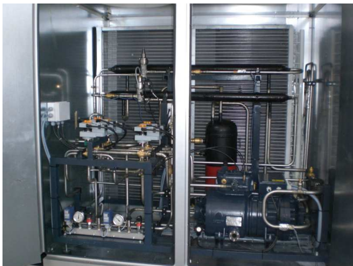
Figura 39 Vista della batteria esterna installata sulla pompa di calore.
