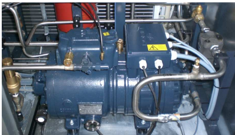
Figura 29 Compressore del roof-top.
