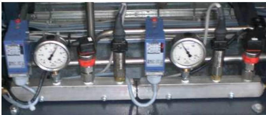
Figura 63 Strumentazione lato CO 2 a bordo roof-top.
