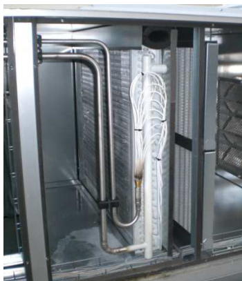
Figura 36 Tipologia di batteria interna installata sulla pompa di calore.
