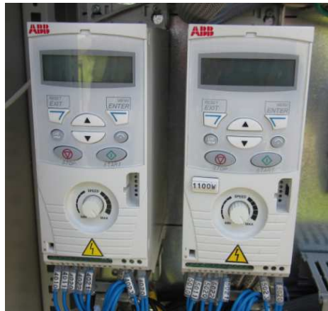
Figura 48 Inverter ventilatori mandata e ripresa.
