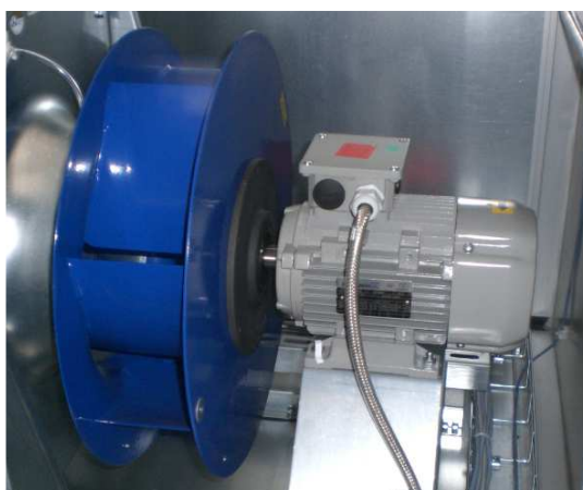
Figura 47 Ventilatore di mandata dell'aria.
