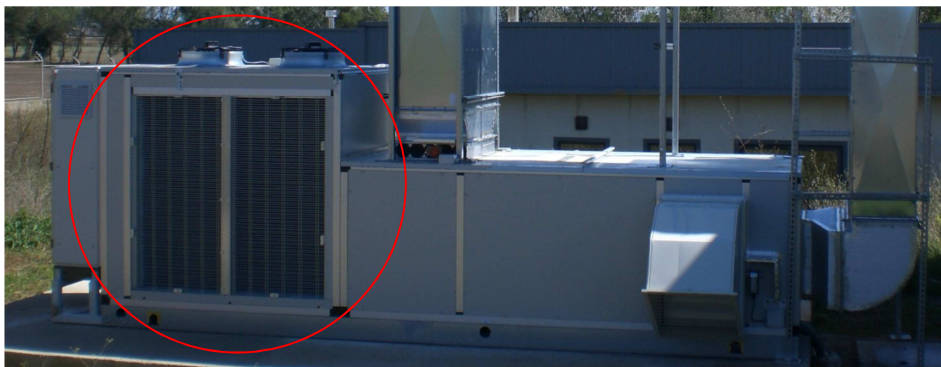
Figura 37 Tipologia di batteria esterna installata sulla pompa di calore.
