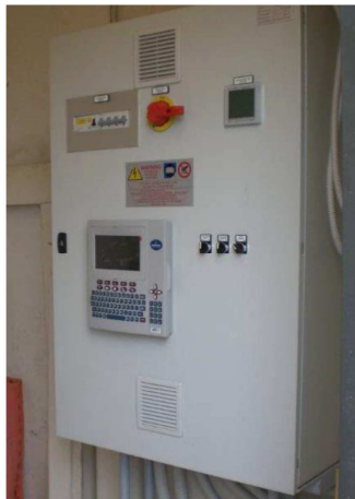
Figura 24 Quadro elettrico di potenza e controllo del roof-top.
