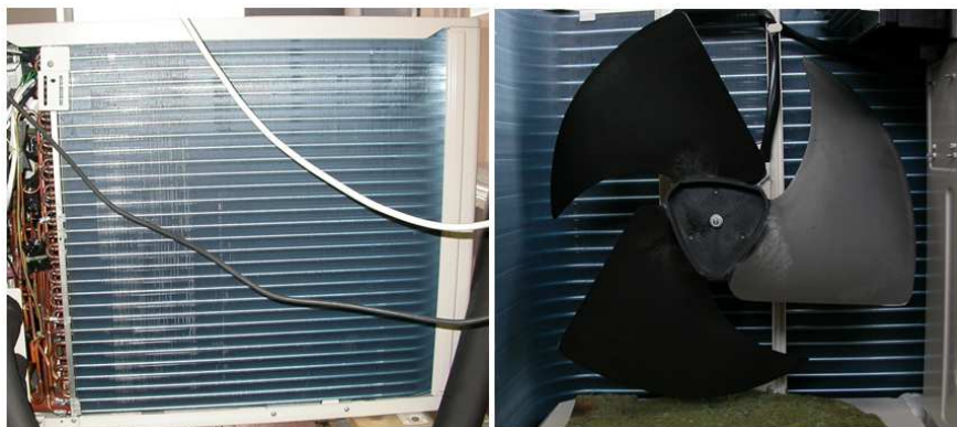
Figura 8 - Scambiatore ad aria (evaporatore)
