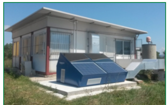
Vista prospettica del locale di prova dell'impianto Solar DEC FREESCO
