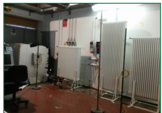
Facility di prova con pompa di calore a CO 2 abbinata a radiatori a elevato salto termico
