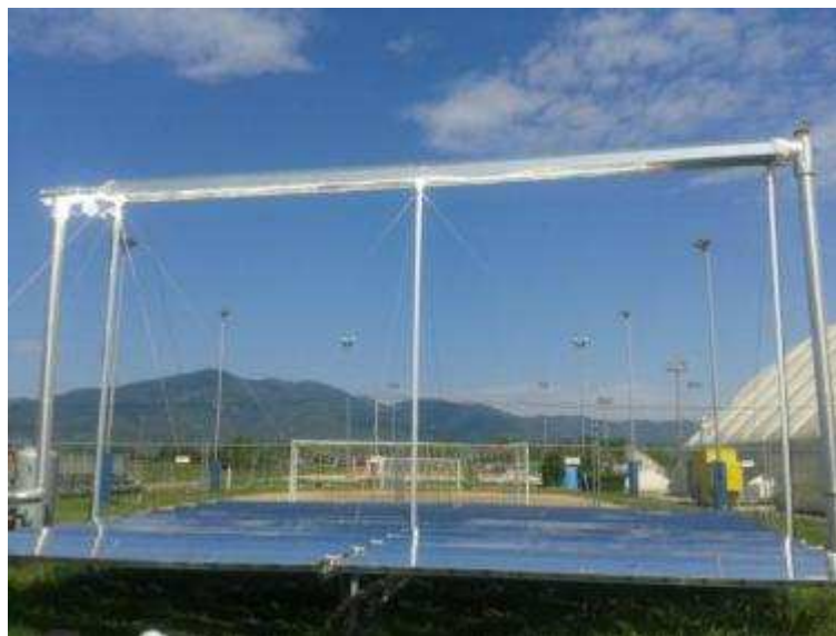
Figura 43: Foto di una seconda installazione su cui sono state eseguite le sperimentazioni in campo (sistema Linear-Fresnel della ditta Glayx Tech)
