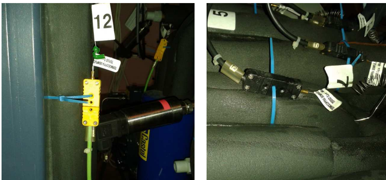
Figura 20. Termocoppie di tipo K (a sinistra) e Termocoppie tipo J (a destra) installate lato refrigerante
