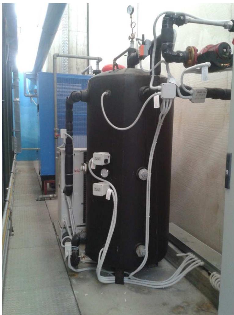
Figura 7. Serbatoio d'accumulo con resistenze elettriche
