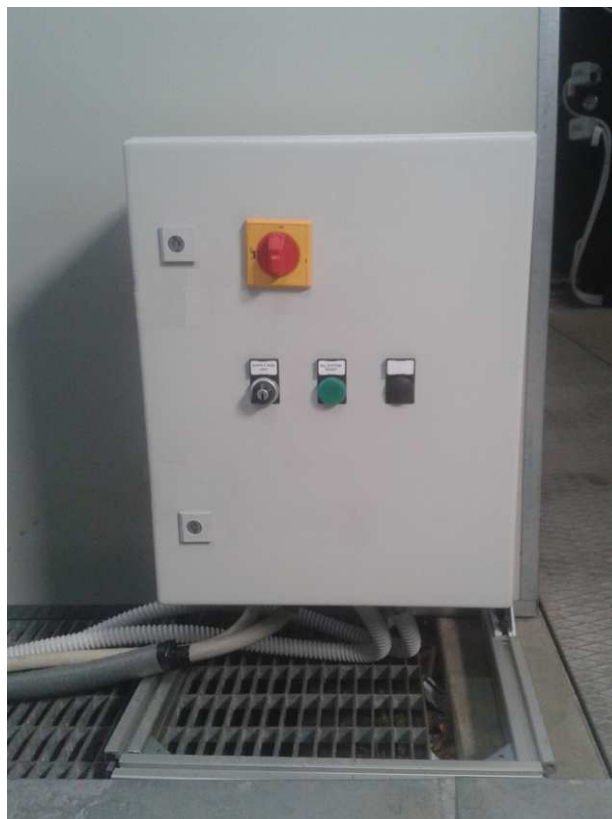
Figura 29. Quadro di sicurezza A, collocato all'esterno della camera climatica
