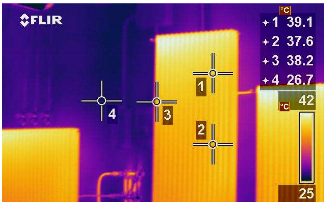
Figura 37. Analisi termografica dei terminali d'impianto installati.
