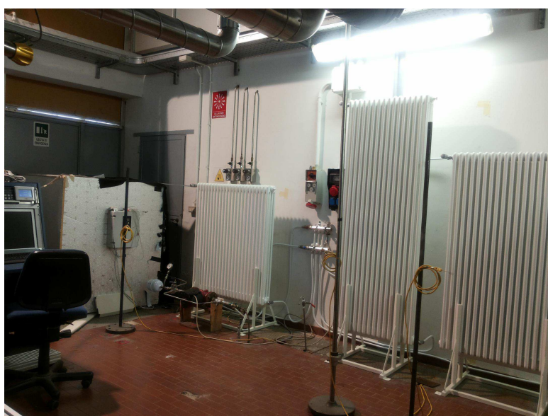
Figura 17. Facility di prova con pompa di calore a CO 2 abbinata a radiatori ad elevato salto termico.
