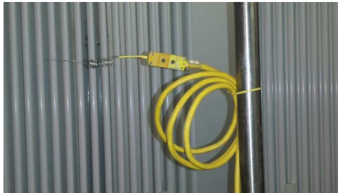
Figura 28. Termocoppia utilizzata per il monitoraggio della temperatura ambiente in cui è installato l'impianto a radiatori.
