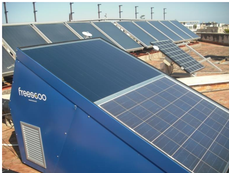
Figura 1: Foto del prototipo freescOO residential installato presso il DEIM dell'Università di Palermo
