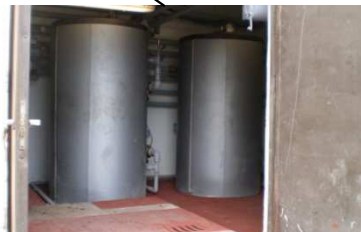
Serbatoi di accumulo termico
