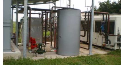
Serbatoi di accumulo a. fredda
