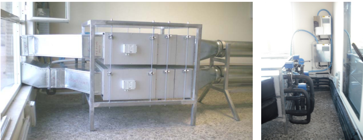
Figura 21: Foto delle due Unità di Trattamento dell'Aria da utilizzare per ottenere prefissate condizioni di umidità, temperatura e portata nei due flussi d'aria da inviare alla cellula di test
