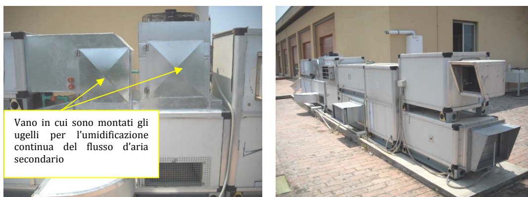
Figura 10: Foto dell'UTA a seguito delle modifiche e dell'introduzione dei due scambiatori di calore
