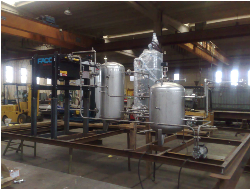
Fig. 18 – Foto del circuito di prova totalmente assemblato su skid
