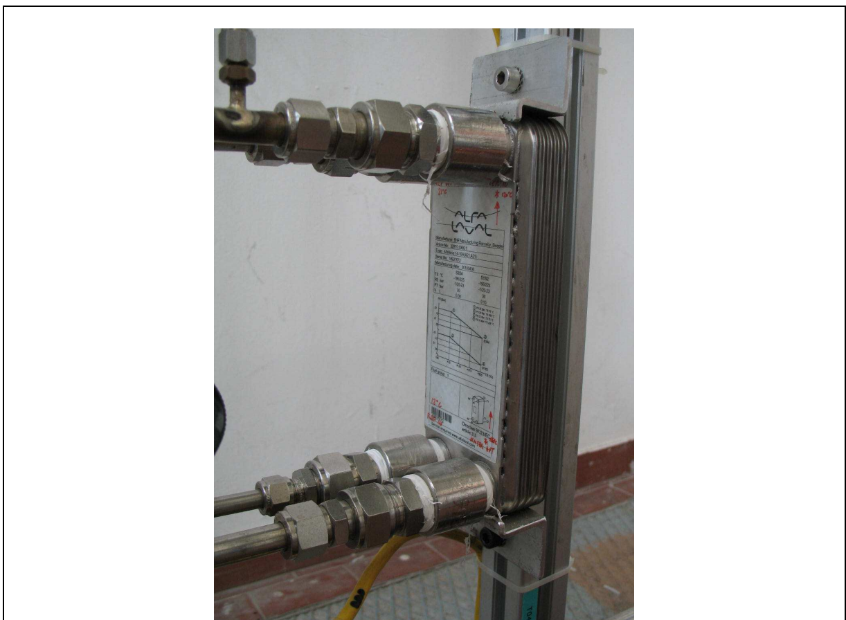
Figura 22 - Condensatore impianto secondario
