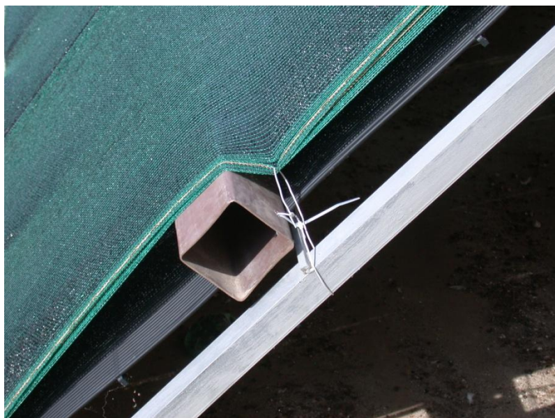
Figura 13; particolare che mostra i distanziatori inseriti per facilitare il passaggio dell'aria.
