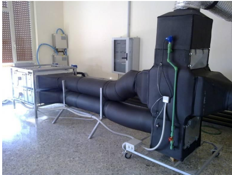
Figura 2 Foto della cella di test per lo scambiatore di calore aria-aria in esame
