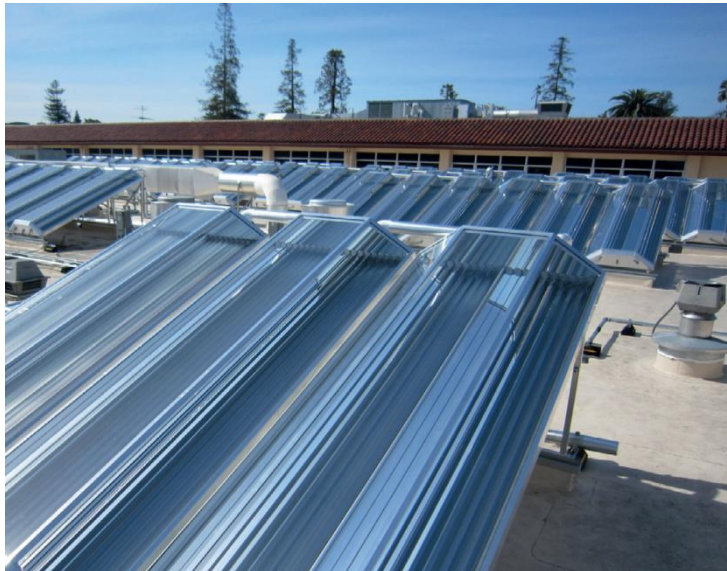
Figura 30 Collettori MCT Chromasun installati alla Santa Clara University (CA, USA)
