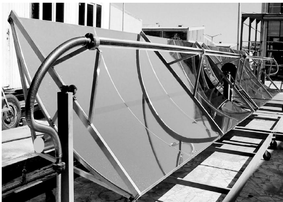
Figura 54 Dettaglio del campo solare dell'impianto [24]
