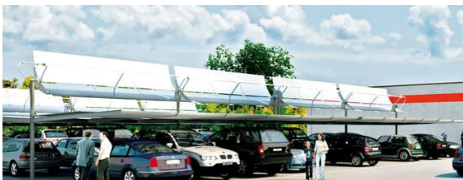
Figura 16 Collettori di Soltigua PTM installati sopra un parcheggio [29]
