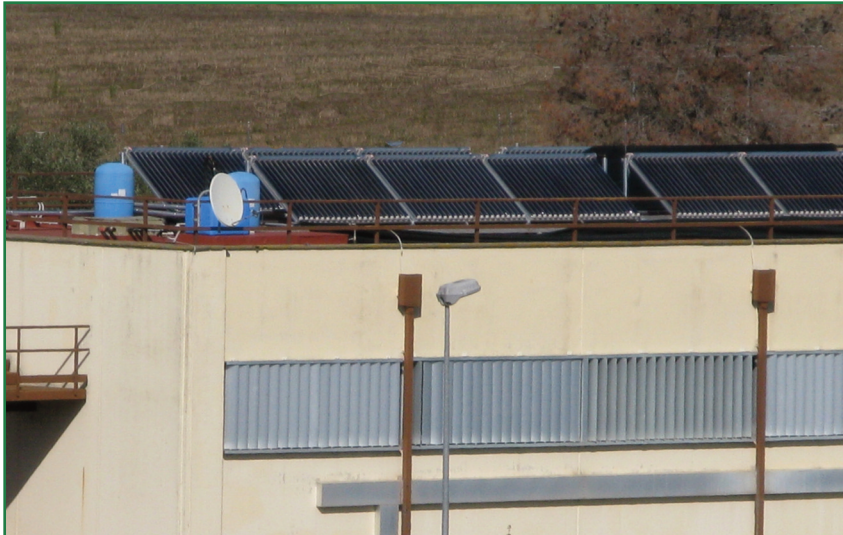
Campo solare Edificio F51 ENEA-CASACCIA
