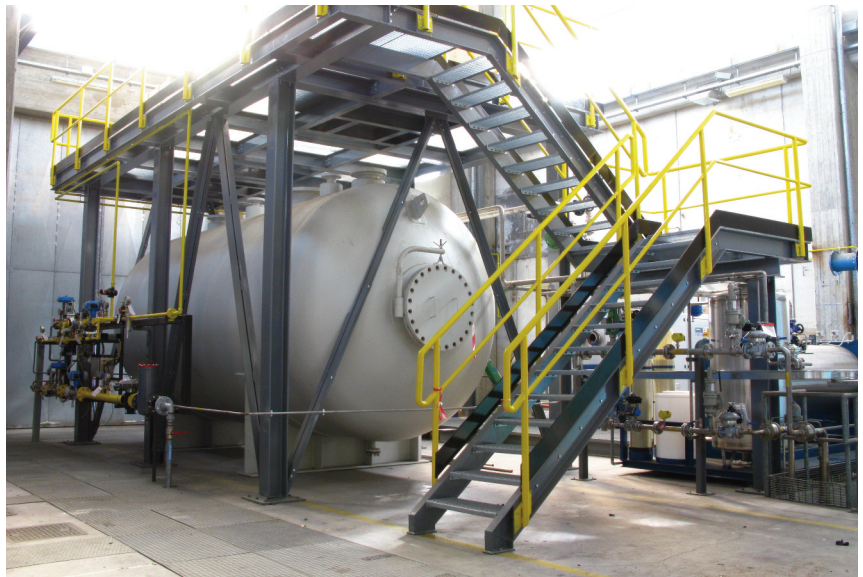
Generatore di vapore
