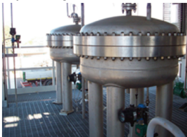
Reattori a bolle per la cattura della CO 2 Impianto Pilota SOTACARBO
