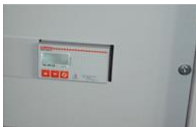
Figura 2.16 - contatore elettrico per il sistema di rigenerazione ammine.
