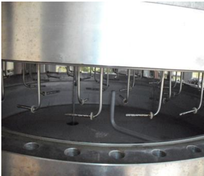
Figura 2.12 - interno del reattore di separazione della CO 2 senza i diffusori
