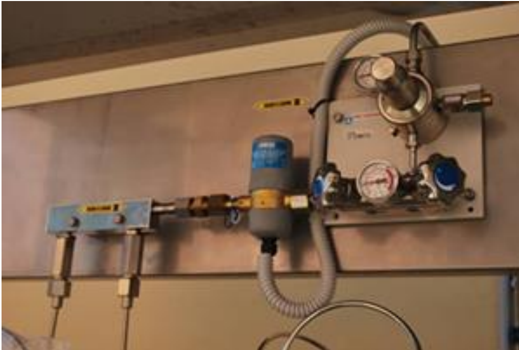
Figura 15-3 Particolare del riscaldatore elettrico e del sistema di riduzione della pressione.
