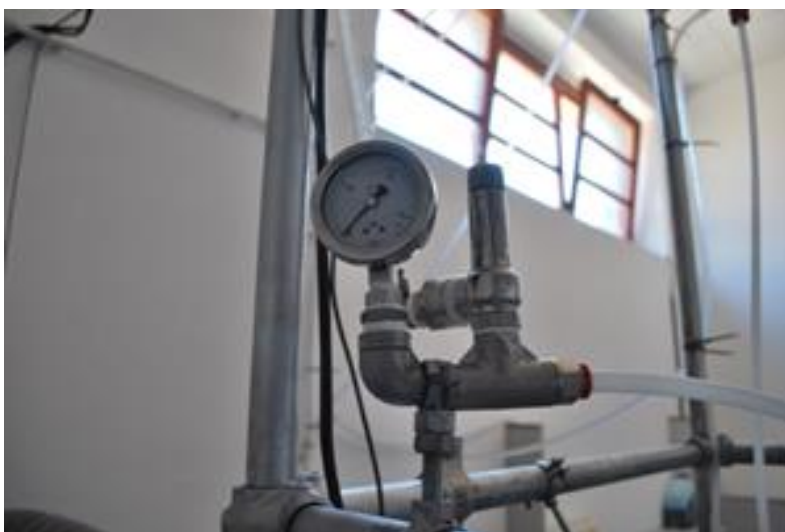
Figura 15-13. Manometro e valvola di sicurezza.
