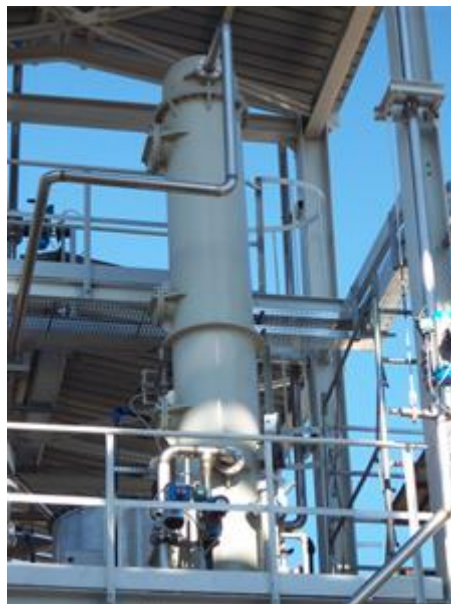
Figura 5-1 Colonna a riempimento di desolforazione a freddo del syngas.
