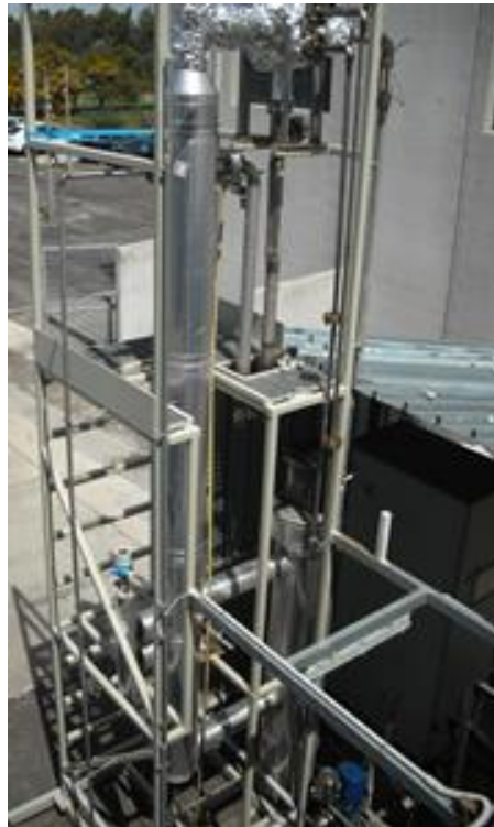
Figura 5-4 Unità di rigenerazione ammine dell'impianto Sotacarbo.
