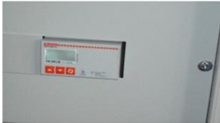
Figura 7-5 Contatore elettrico per il sistema di rigenerazione ammine.
