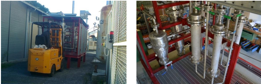
Figura 2. Impianto GESSICA: installazione e vista di insieme della nuova sezione di clean up
