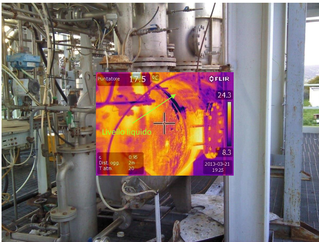
Figura 10. Impianto Piattaforma Pilota: termometria IR del tank del clean up
