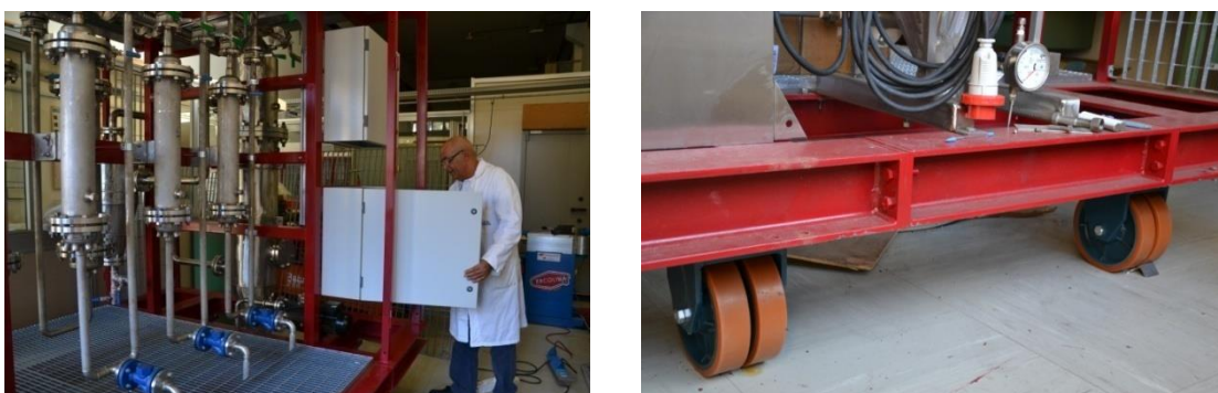
Figura 3. Impianto GESSICA: sezione di upgrading del syngas e dettaglio ruote movimentazione skid
