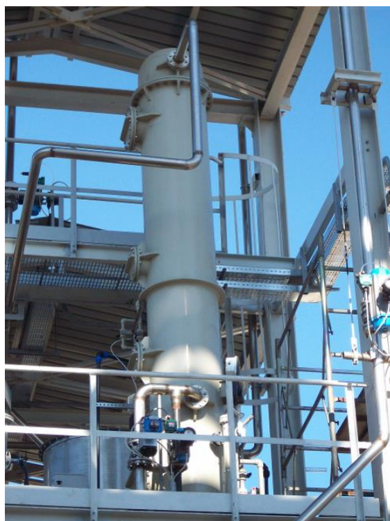
Figura 8 Colonna a riempimento di desolforazione a freddo del syngas.
