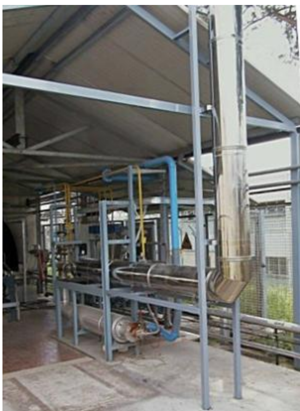
Figura 2-5: Vista del condotto di scarico dei fumi.
