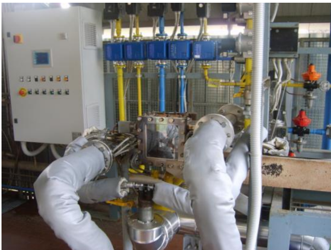
Figura 2-2: Vista del TVC dell'impianto di alimentazione e controllo aria e combustibile.
