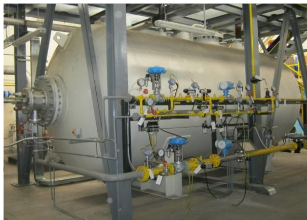
Figura 5. Vessel. Vista lato combustore e rampa gas.
