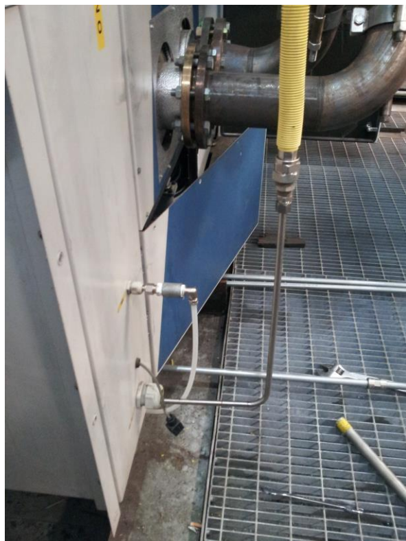
Figura 16. Intervento a bordo macchina per l'esclusione del compressore di alimentazione.
