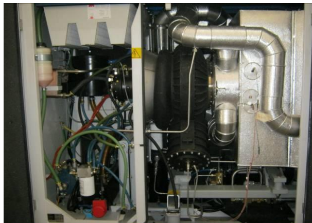
Figura 3. Turbec T100 modificata per la connessione fluidodinamica al vessel. Vista lato combustore.
