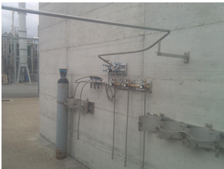
Figura 8 Installazione di un circuito valvole per la rampa gas di alimentazione CO
