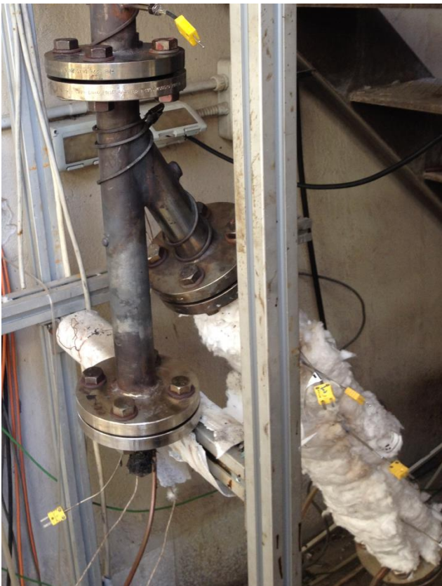
Figura 6: Particolare: reattore di pirolisi e gassificazione.
