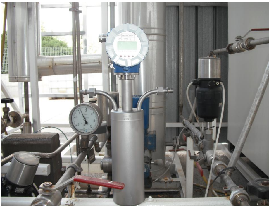
Figura 6. Misuratori di densità di nuova installazione.
