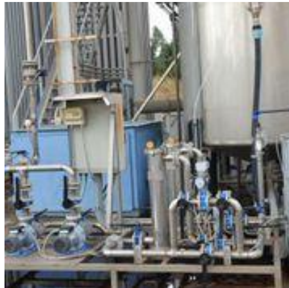
Figura 2.9 vasca di accumulo e sistema di ricircolo acqua di lavaggio.
