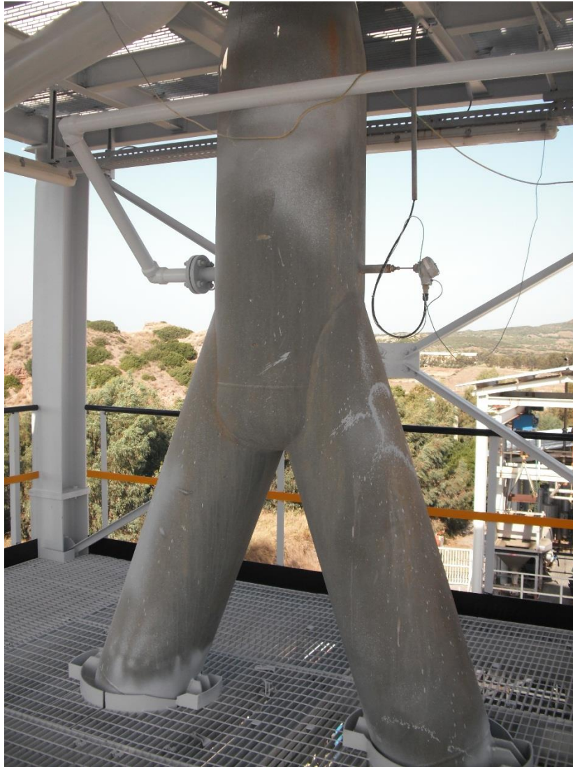
Figura 2.2 Tubazioni del sistema a Y per il caricamento del combustibile nel gassificatore.
