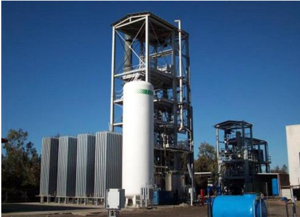
Figura 1.1 - La piattaforma pilota Sotacarbo
