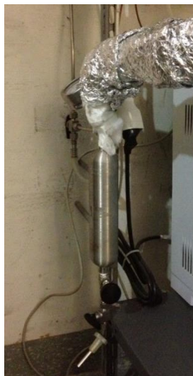
Figura 2.9: Zona del vent dell'impianto Fischer-Tropsch
