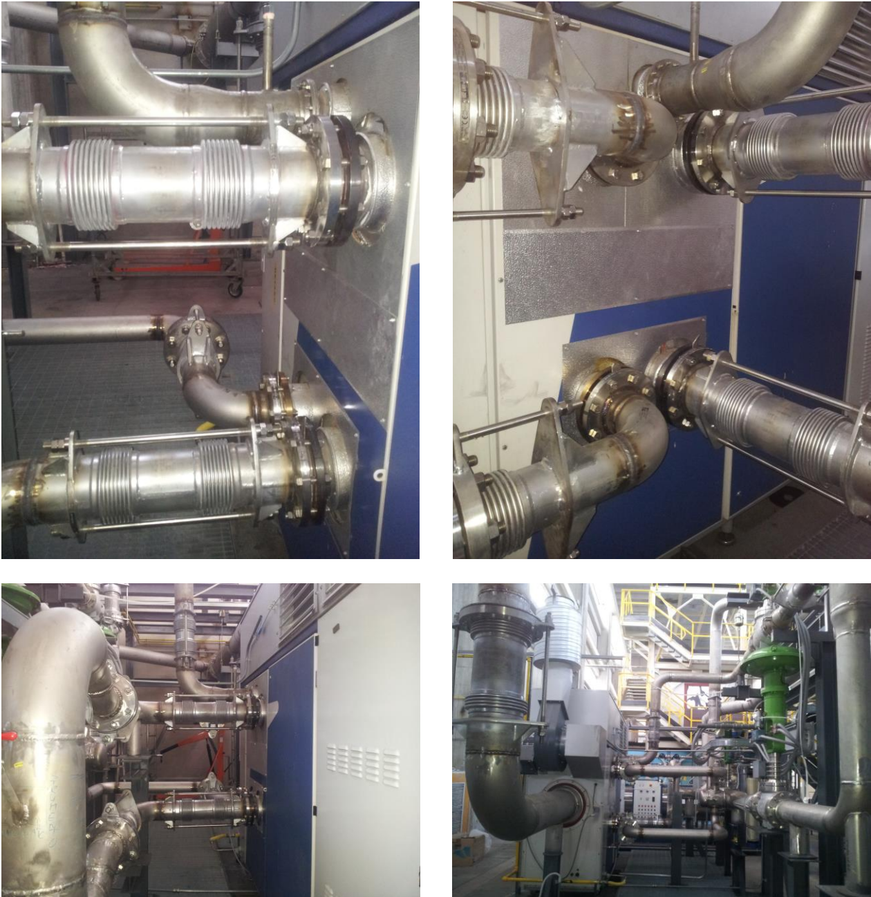
Figura 3. Chiusura del loop di rigenerazione della \mu GT. Il sistema di tubazioni consente di esercire la macchina in configurazione “stand alone” o connessa fluidodinamicamente al vessel.
