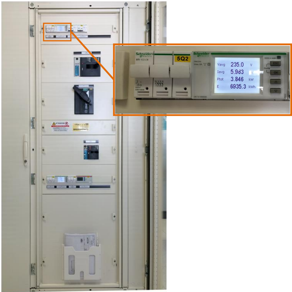
Figura 10 - ZECOMIX - sala controllo; quadro di potenza della TURBEC T100.
