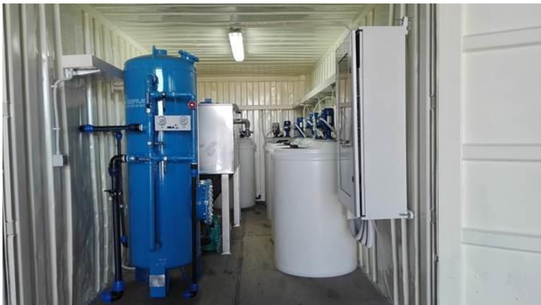
Figura 12. Vista di insieme dell'impianto di trattamento acque reflue
