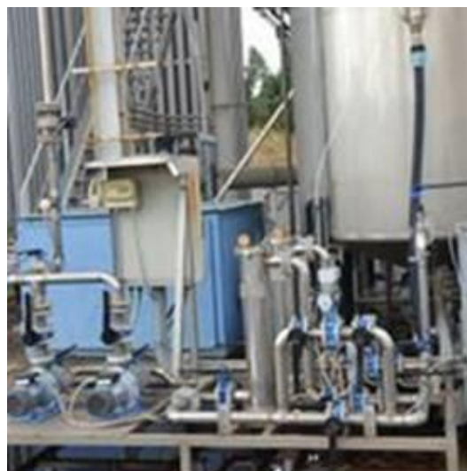
Figura 10. Vasca di accumulo e sistema di ricircolo acqua di lavaggio
