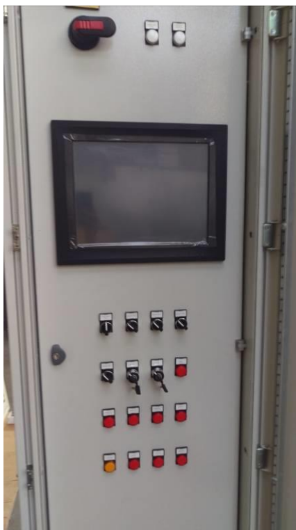
Figura 4-1 Quadro elettrico di controllo
