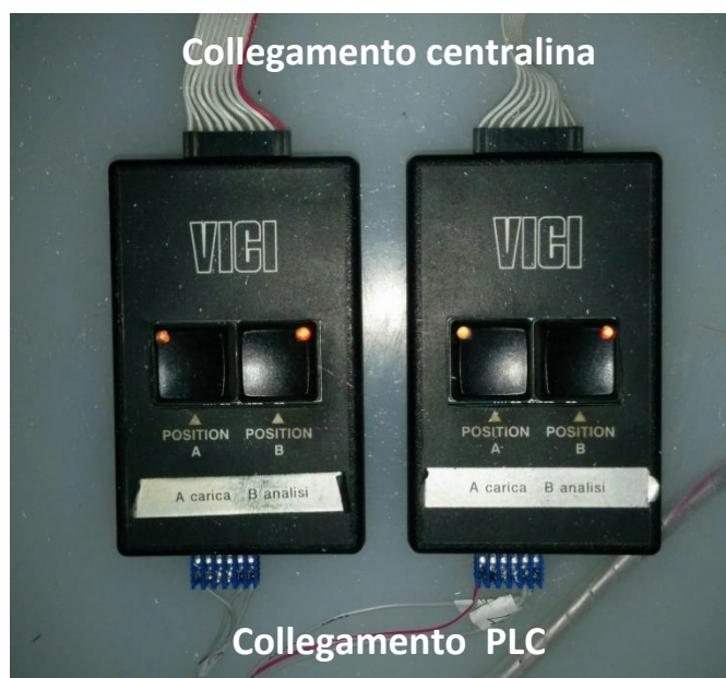
Figura 2.16. Telecomandi delle valvole con doppio collegamento
