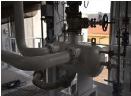
Sistema di raffreddamento: Steam drum
