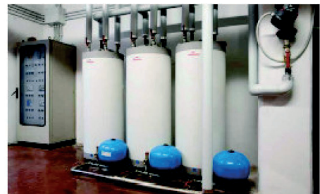
Fig. 11.d - Bollitori per acqua sanitaria
