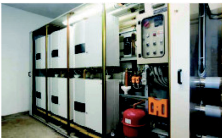
Fig. 11.c - Caldaie a condensazione
