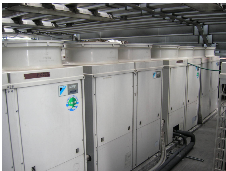
Figura 2. Unità esterne condensanti / evaporanti installate nel sottotetto lato via Palazzo di Città
