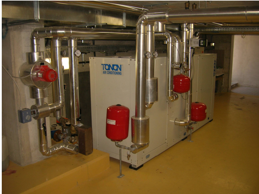
Figura 3. Pompa di calore
