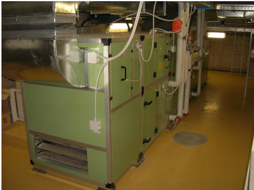
Figure 2. Unità di Trattamento Aria
