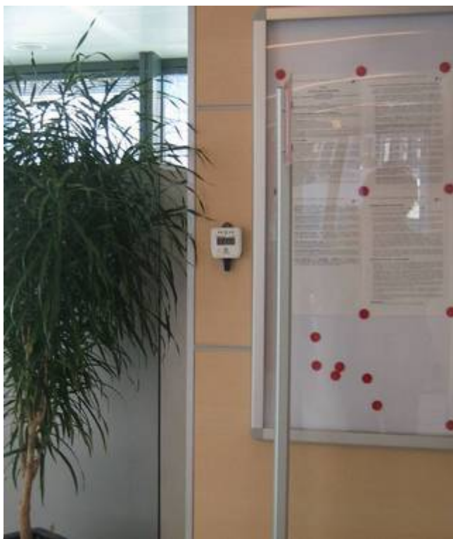
Figura 4: Tipica installazione di un logger di temperatura ed umidità relativa.
