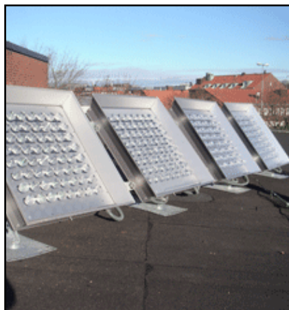
Figura 1.70. Università di Lund, Svezia, impianto di illuminazione a fibre ottiche: pannelli solari di captazione.
