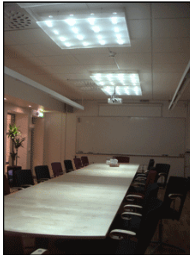
Figura 1.71. Università di Lund, Svezia, impianto di illuminazione a fibre ottiche: sistema di diffusione della luce.
