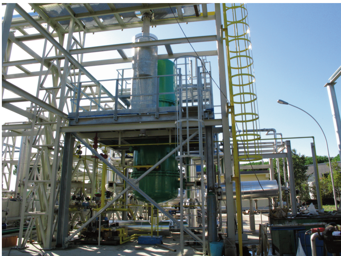
Impianto ZECOMIX per studi sperimentali sulla gassificazione del carbone per produzione di energia elettrica con emissioni zero
