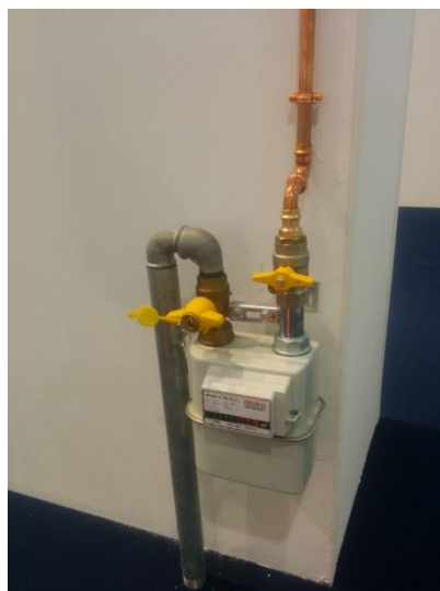
Figura 3. Particolare valvola di regolazione gas
