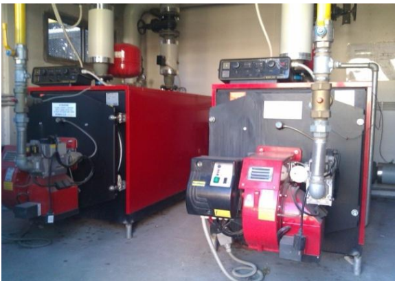
Fig. 3 – Caldaie esistenti da 350 kW th , ciascuna
