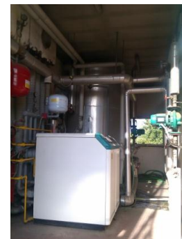
Fig. 16 – Centrale Termica edificio A.
